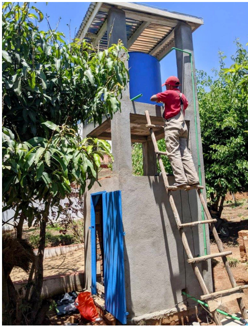
Der Wasserturm steht! Eine Pumpe befördert nun das Wasser aus dem Brunnenloch nach oben....
